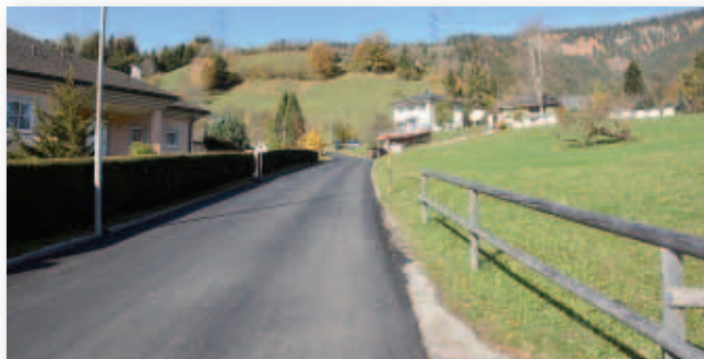
Zwei Teilabschnitte der ebenfalls schon sanierungsbedürftigen Höhenstraße wurden im Herbst dieses Jahres noch erneuert.
